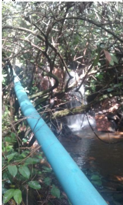
LEGENDA - Captação d'água na Cachoeiras das Araras (Antiga Benvenuto)
